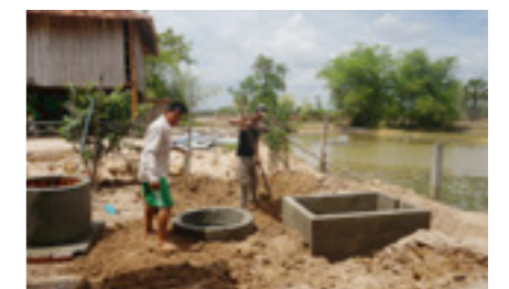
▶ Durch die Nutzung von Biogas werden auch weniger Wälder abgeholzt.
